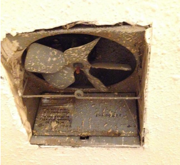
Washroom Exhaust Fan
